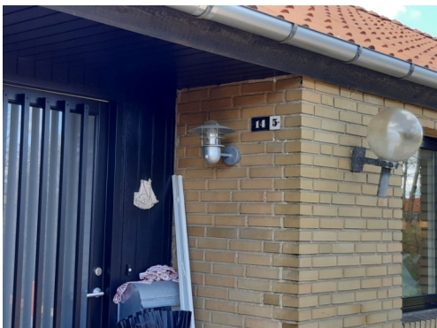
Nr. 145 Skade ses som sivning ud for samlebrønd. Kommer fra bryggers.
