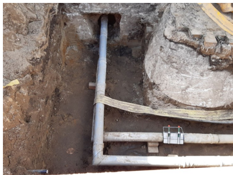
Teststed lige før knæk ind til huset. Er siveskaden mere udbredt?
